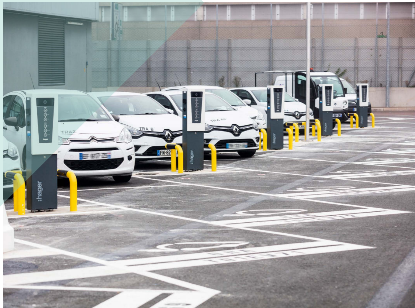
Bornes de recharge de véhicules électriques.
