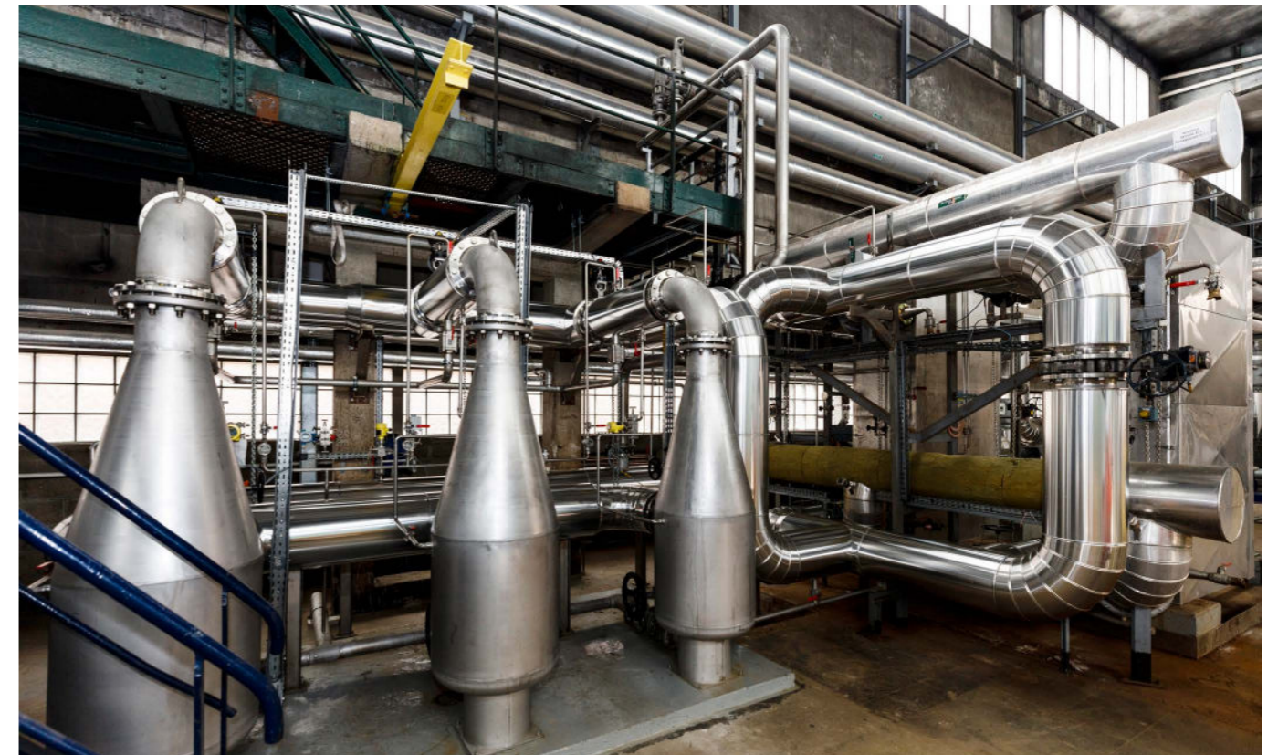
Filtres cycloniques géothermie, Centrale-thermo-frigo-électrique (CTFE), Paris-Orly.
