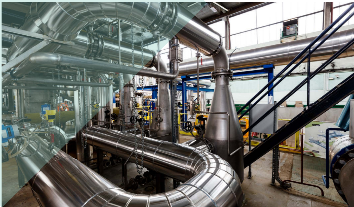
Filtration géothermique, centrale-thermo-frigo-électrique (CTFE), Paris-Orly.
